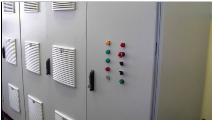
Рис. ПЗ.1. Общий вид шкафов каскадного преобразователя
